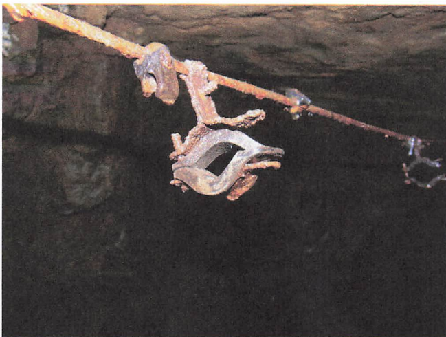
Tragseil für Beleuchtungsleitungen
