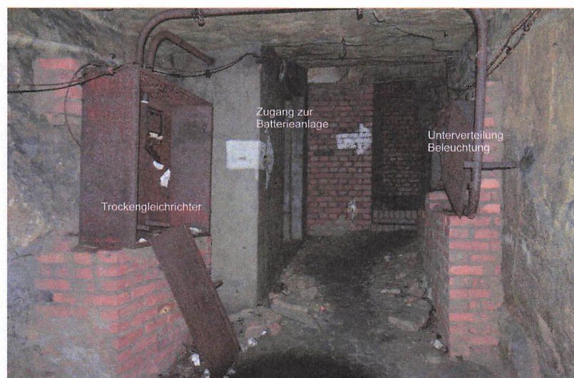
Schaltschränke im Raum 39 (Blickrichtung nach Westen)
