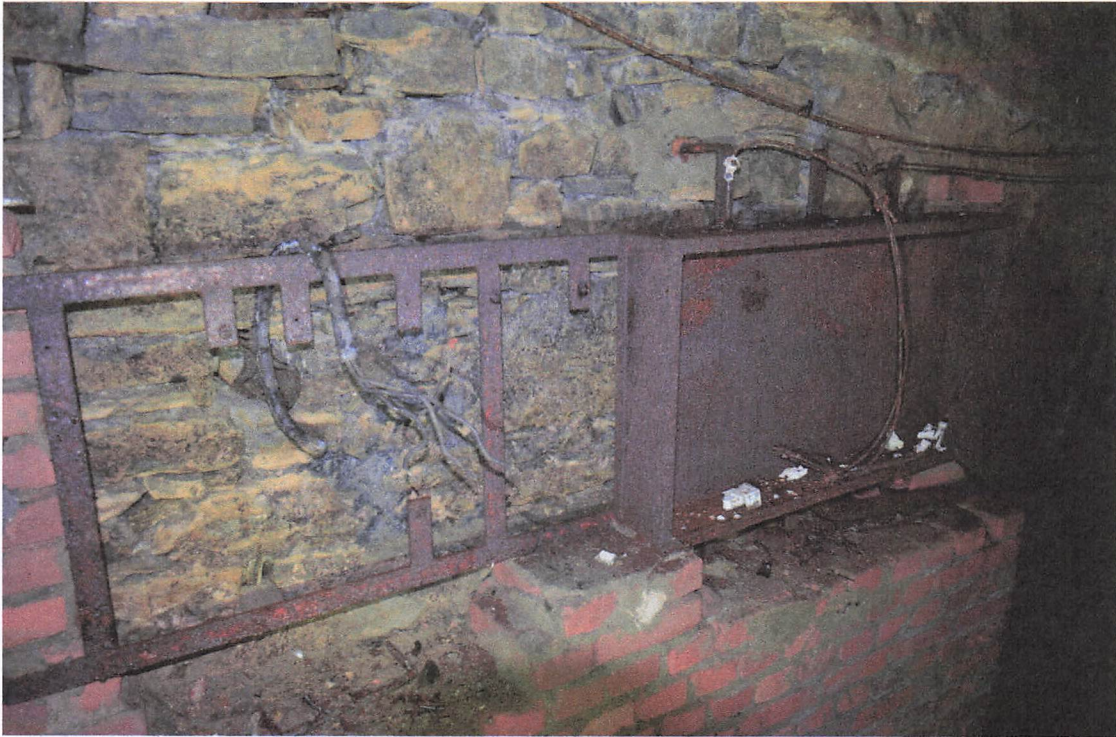
Unterverteilung für die Beleuchtung
